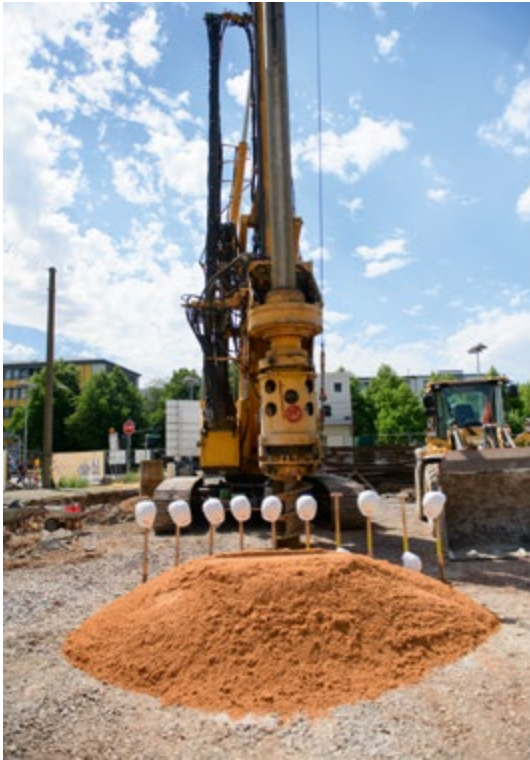
Mit dem Spatenstich fiel im Sommer 2022 der Startschuss für die Bauarbeiten. Foto: Jennifer Weyland
